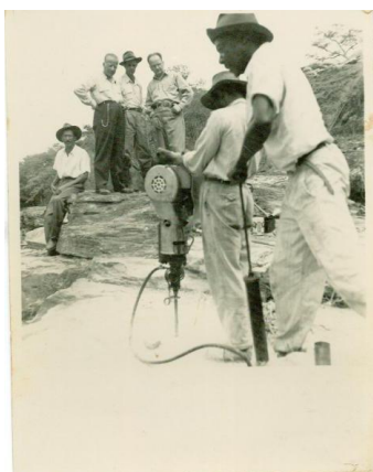
Início das obras. Em primeiro plano, o “Casquinha”. Ao fundo, em pé, o Professor João Franzen de Lima, o Prefeito Tuchê e o engenheiro responsável pela obra, Dr. Silvio Barbosa.
