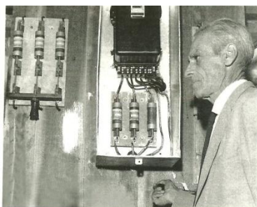
Prefeito Salvador acionando um mecanismo da Usina
